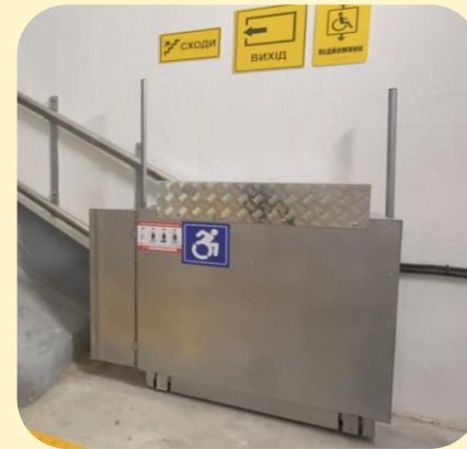
зразок встановлення похилого підйомника в захисній споруді цивільного захисту
